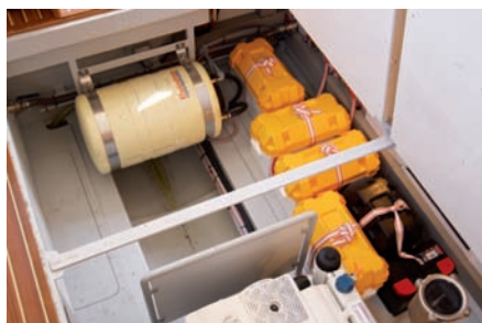
Verbraucher- und Starter-Batteriebank nebst Warmwasserboiler.
